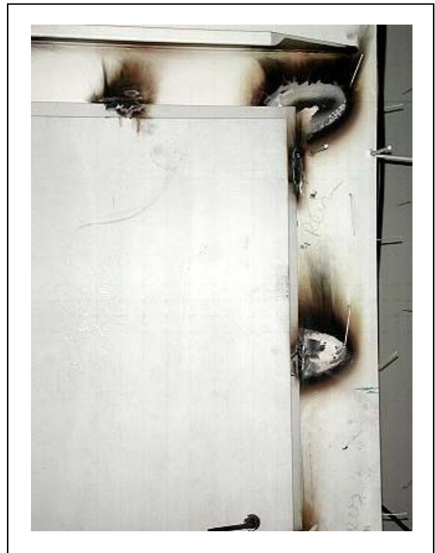
Bild 7: Nachträglich eingeschweißter Türrahmen auf bereits endkonservierter Wand
