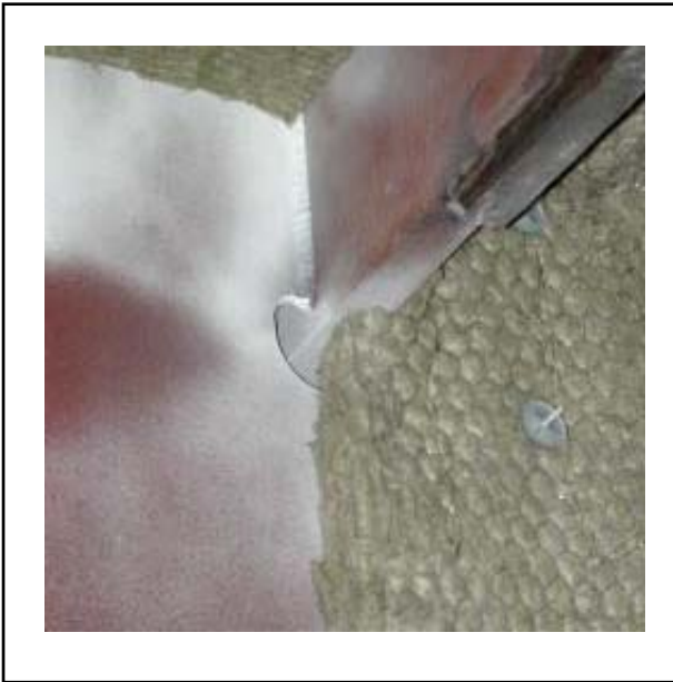
Bild 4: Beispiel für einen Bereich mit montiertem Dämmmaterial, in dem beim nachträglichen Schweißen besondere Vorsicht geboten ist
